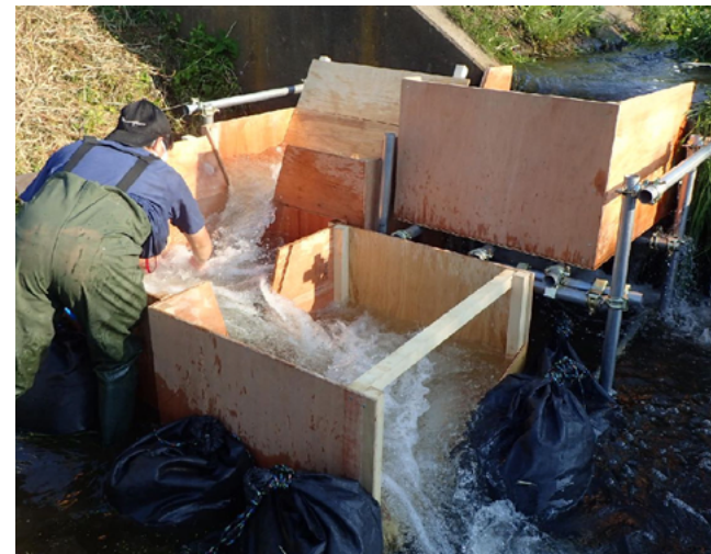
図11 ウエンベツ川の落差工にセットされた可搬魚道。
